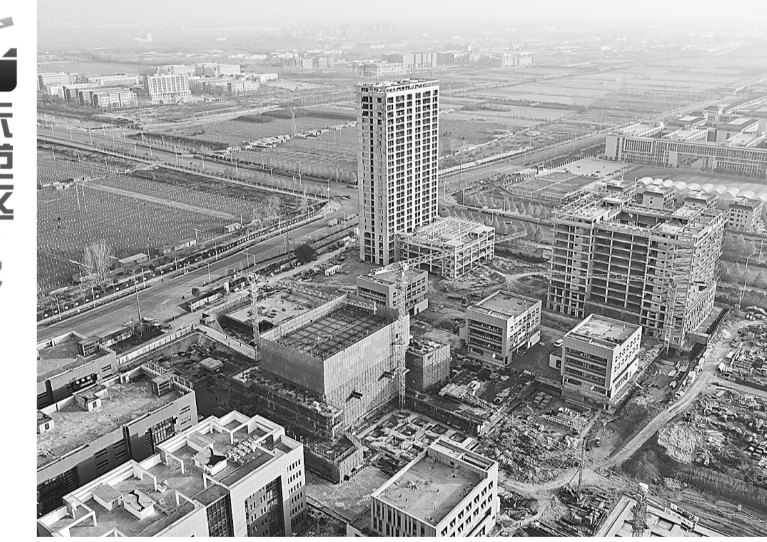
河南理工大学科技园二期项目,是以工业设计为核心的创新产业园区,项目总投资12亿元,目前在建面积达15万平方米,现有入园企业260家,园区企业拥有专利161项。图为12月4日,建设中的河南理工大学科技园二期项目。
